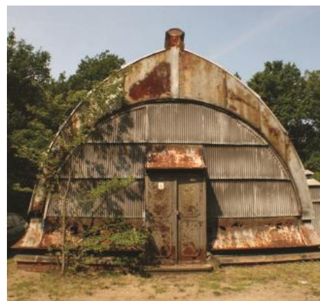
Korrosionsschäden beeinflussen die Standsicherheit des Meridianhauses
