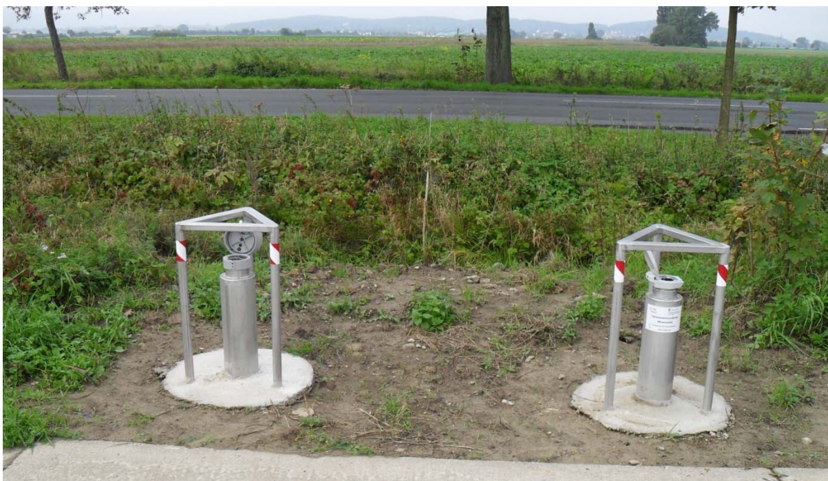
Abbildung 2: Messstellenbereich mit zwei Grundwassermessstellen
